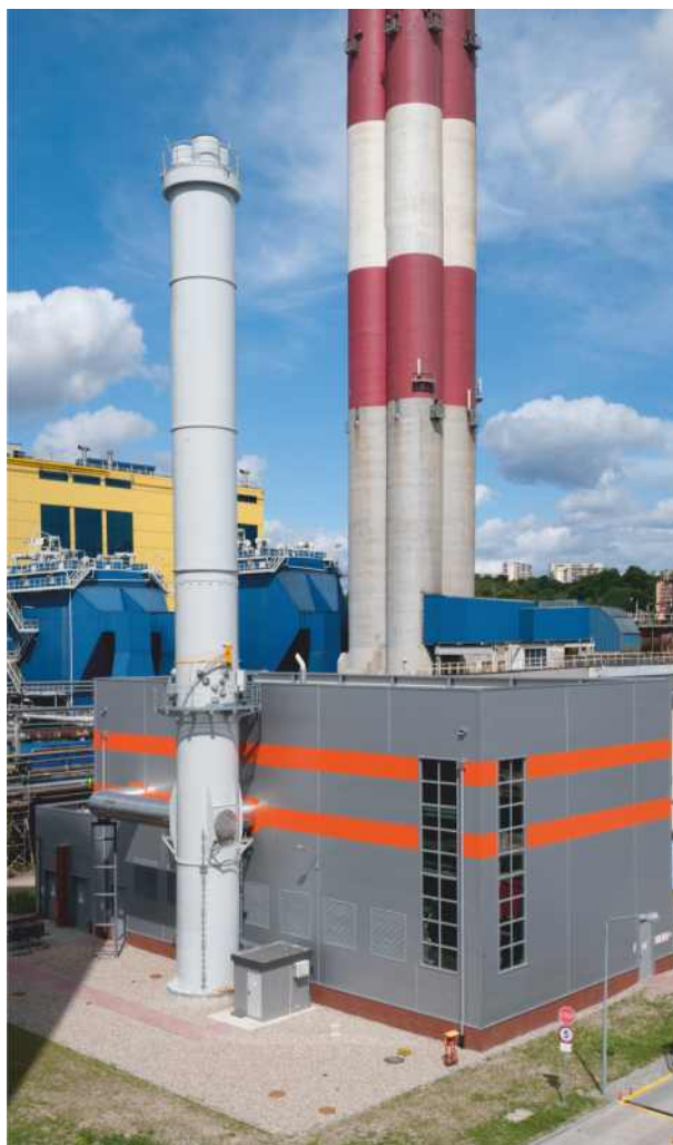
Nowa kotłownia olejowa w EC Gdyńskiej
